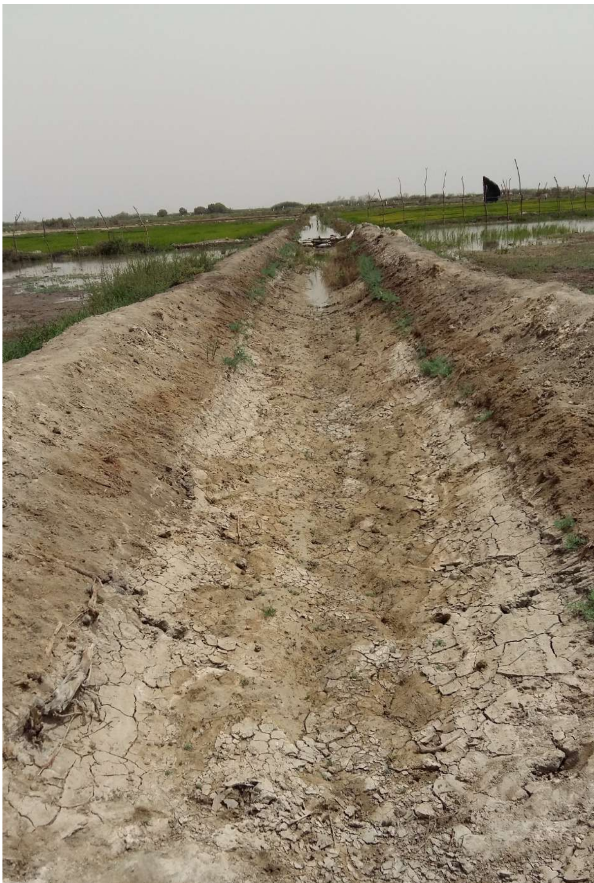
ANNEXE 8 – "Canal de drainage" asséché
